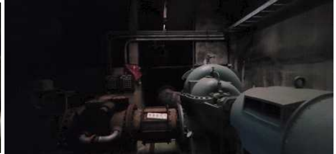
지하 2층 펌프실
