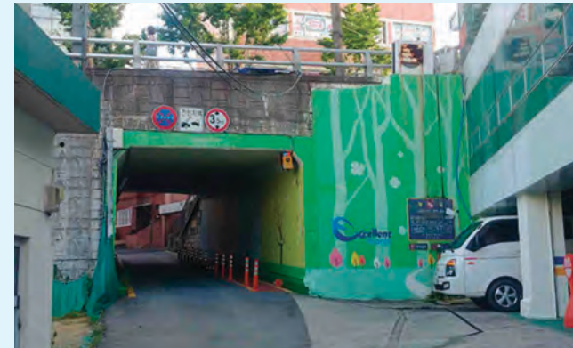
옹벽 개선 전
