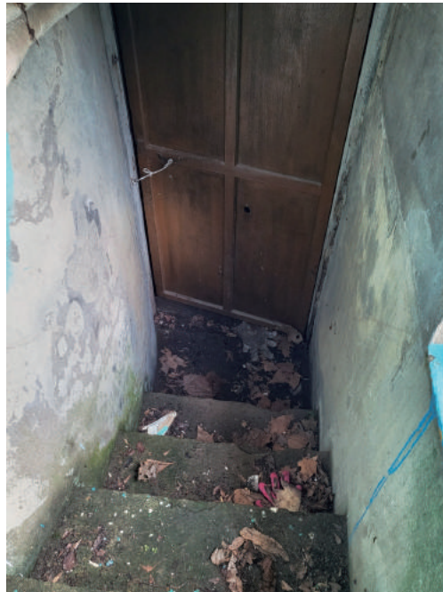
안양의 집(자연학습장) 지하시설
